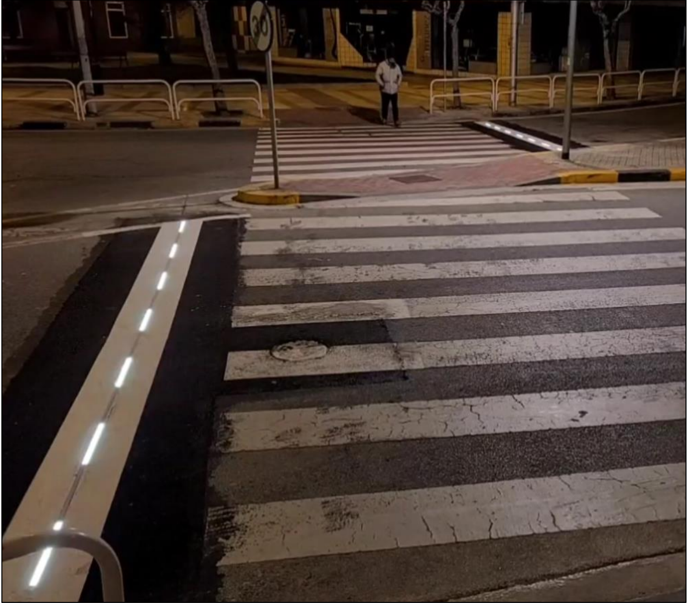
Paso de peatones Stopled Street Light en Pamplona.
